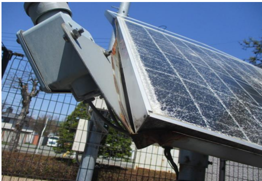
雪により太陽光パネルが破損
