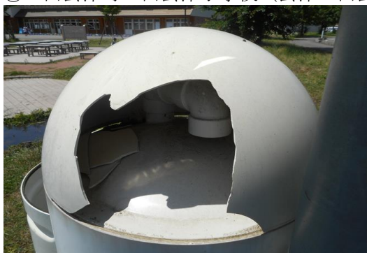
ドーム部分の破損
