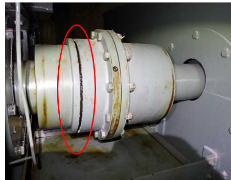
ギアカップリングカバー損傷部
