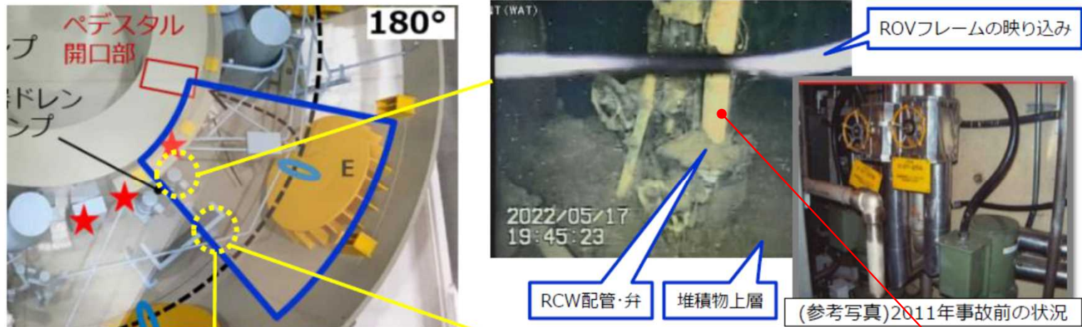
写真1.機器ドレンサンプポンプ付近の状況
