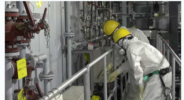
検査官によるALPS巡視の様子
