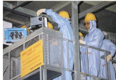
監視装置の保守管理
