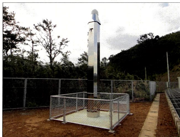
黒島の機器設置状況
