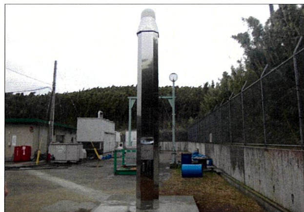
竹島の機器設置状況
