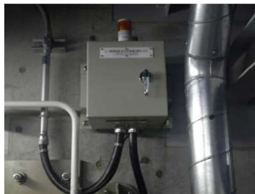
図2 現場盤（ブザー付き表示灯）
