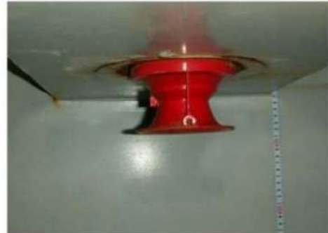
ポンプ部ベルマウス
