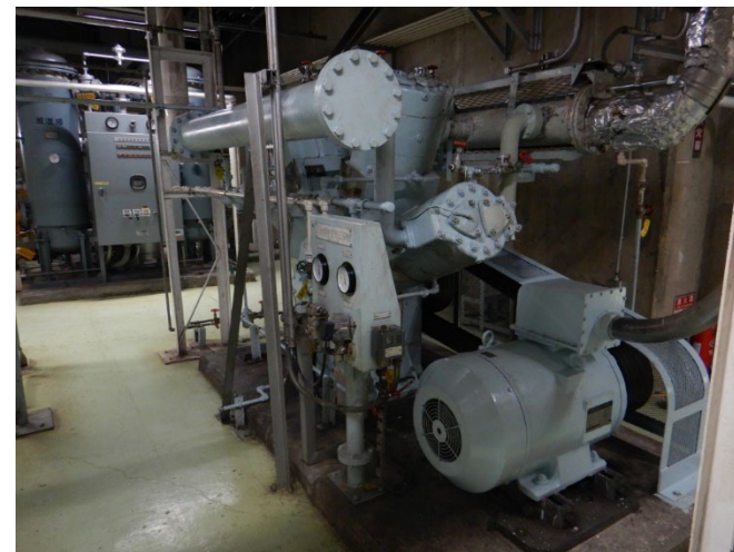
既設の空気圧縮機
