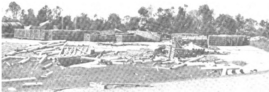
図 6.4-1 Grand Gulf 原子力発電所資材置き場におけるパイプの散乱状況
