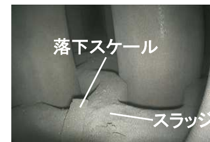
スケール回収画像（C-SG 第一管支持板） （高浜発電所4号前回（第23回）定期検査の薬品洗浄前）
