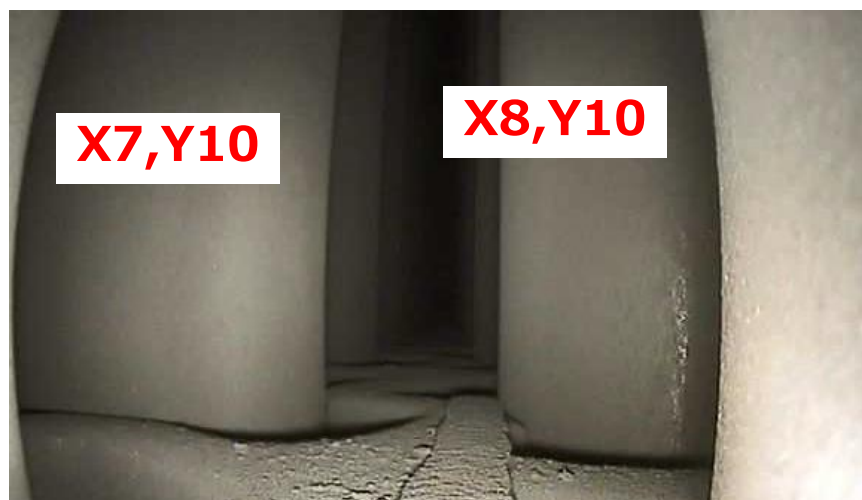
A-SG 第一管支持板上写真
