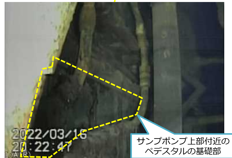
写真3.ペDESTAL基礎部付近の状況②
