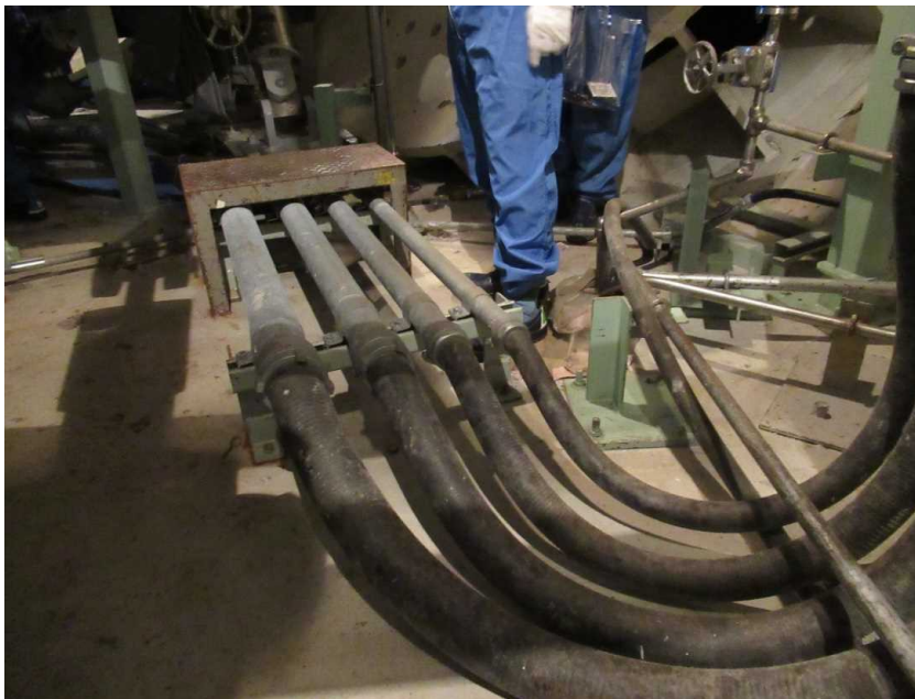
再循環ポンプ動力ケーブル
