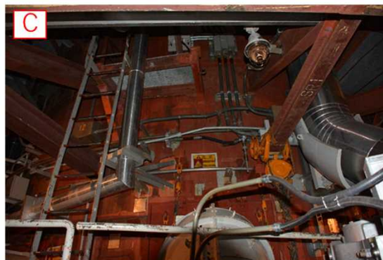
金属保温材 (再循環配管廻り)
