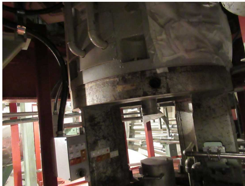
原子炉再循環ポンプモーター
