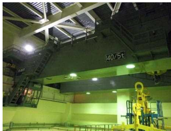
キャスク搬出入エリア天井クレーン
