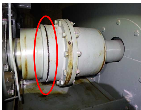
ギアカップリングカバー損傷部
