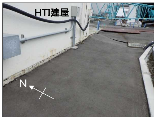
HTI建屋南側沈下状況
