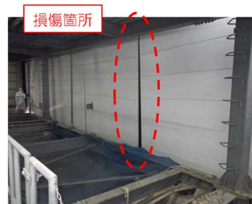
【写真③】 損傷を確認した外壁 （外側から撮影）
