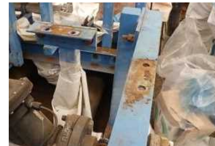
サポート部（配管取外後）
