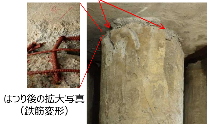
図21 No.8杭の杭頭部の損傷状況
