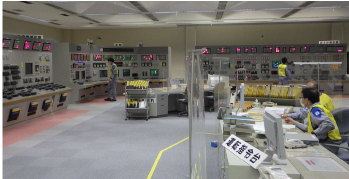
【中央制御室（シミュレータ室）】
