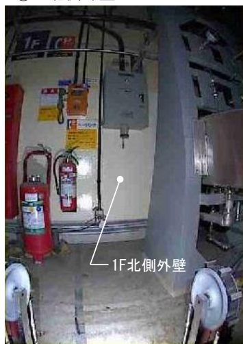
①1F北側外壁
