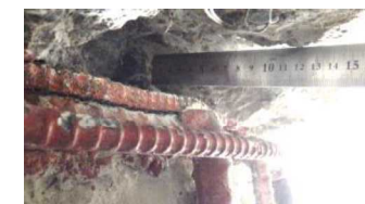
No.8杭主筋の破断状況
