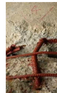
No.8杭主筋の変形状況
