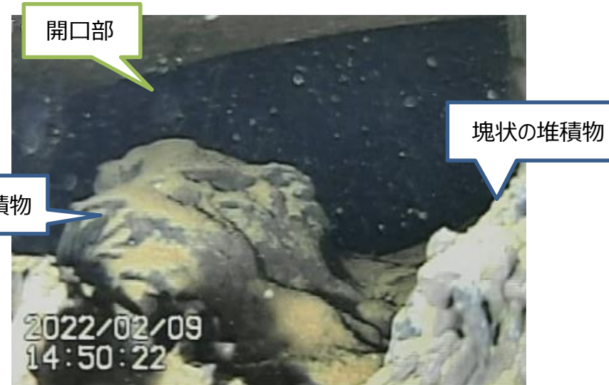
C. ペDESTAL開口部内部
