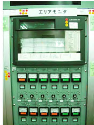
監視盤 (放射線管理室)
