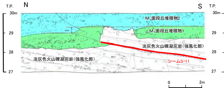
Ts-7トレンチ東側法面: 変状が認められる (見掛けの鉛直変位量約30cm[段丘堆積物中の層理面の段差]) (補足説明資料P.4-20参照)
