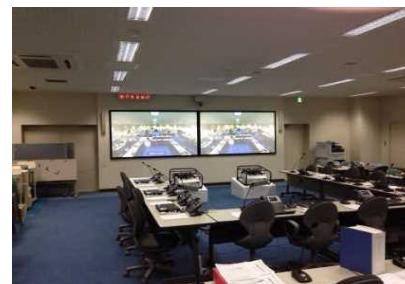
TV会議システム等通信設備
