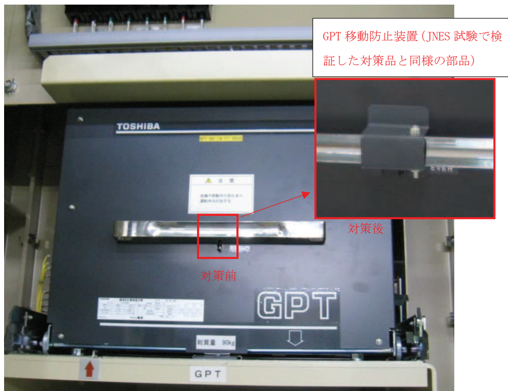
図 GPT 移動防止装置の取付対策（例）
