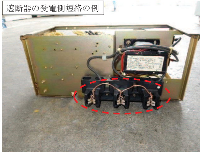
図 4.5.3 遮断器の短絡箇所 (MCC 試験時)
