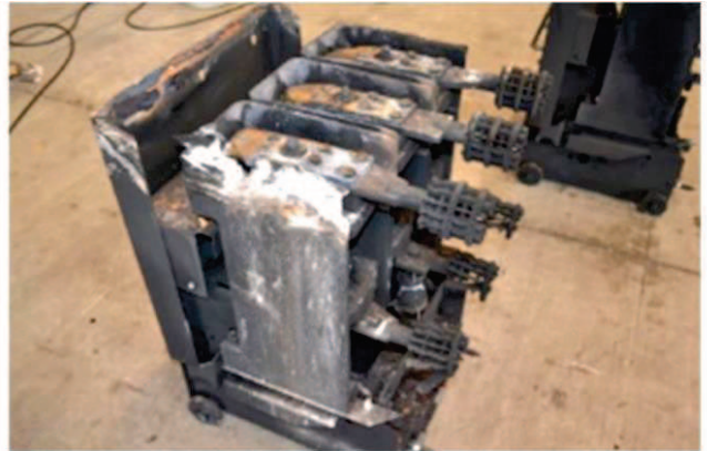
遮断器室アーク発生、アーク火災有、消火後の遮断器の様子
