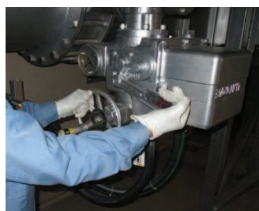
現場手動ハンドルによる開操作
