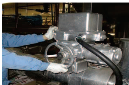
現場による電動弁の手動操作例
