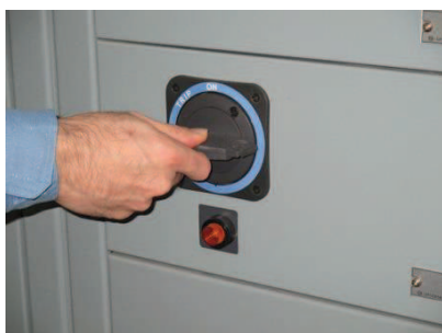
遮断器「切」操作
