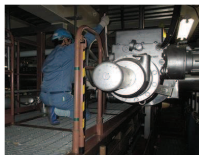
現場手動ハンドルによる開操作
