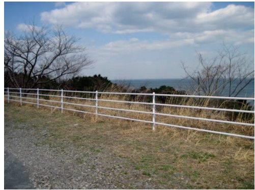
状況写真①
