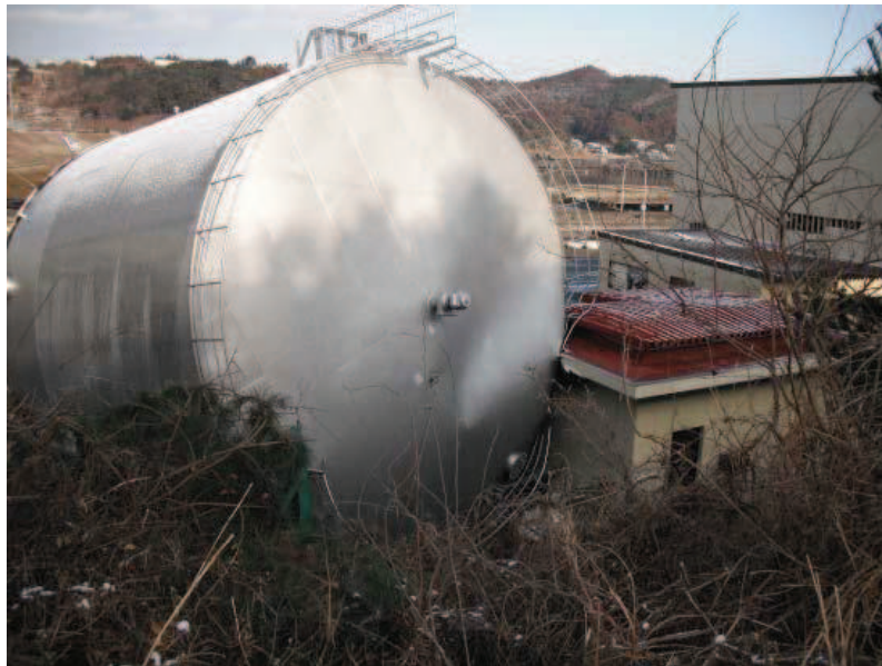
写真 4. 2-1 (9) 敷地内で確認された東北地方太平洋沖地震に伴う津波の漂流物 (0. P. +2. 5m に設置されていた第 1 号機補助ボイラー用の重油貯蔵タンク)
