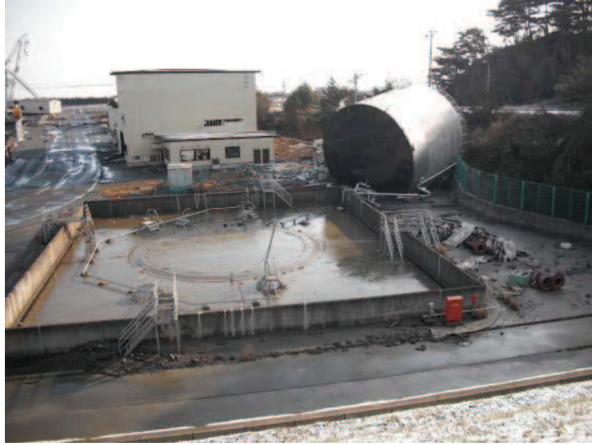
写真 4. 2-1 (8) 敷地内で確認された東北地方太平洋沖地震に伴う津波の漂流物 (0. P. +2. 5m に設置されていた第 1 号機補助ボイラー用の重油貯蔵タンク)
