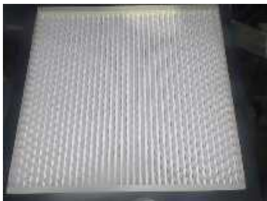
移替え元排気フィルタ（2段目）
