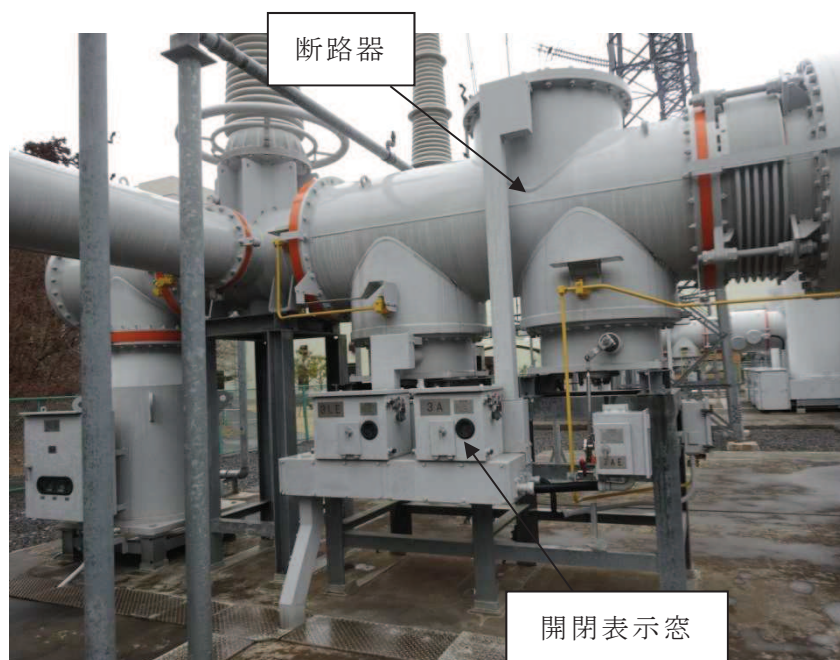
図 1-27 断路器の外観（開閉状態確認イメージ）
