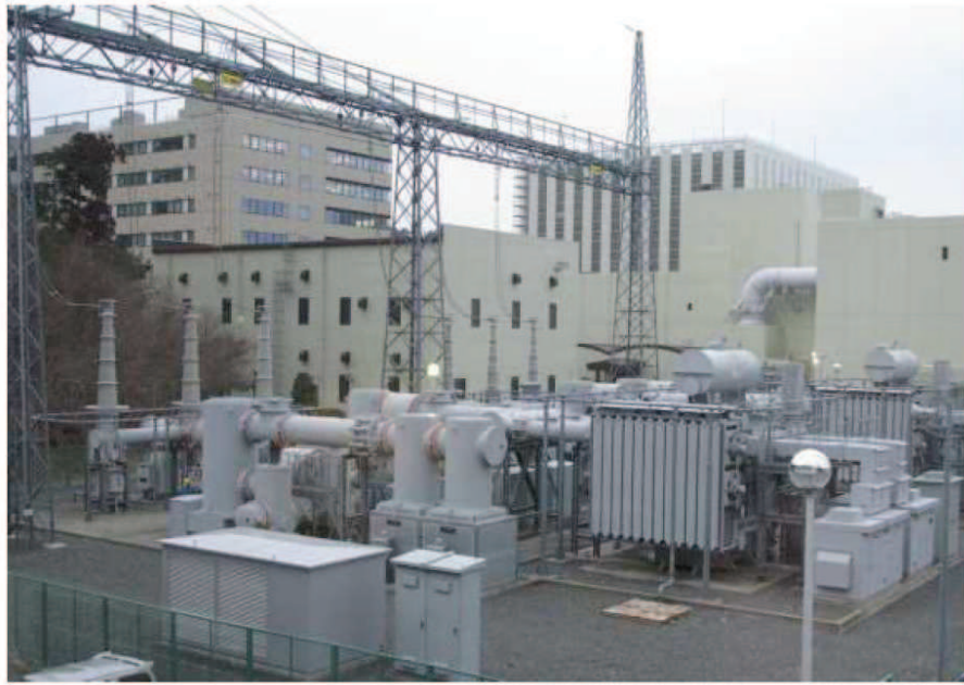
図 3-16 275kV 開閉所の外観
