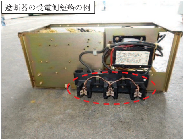
図 4.5.3 遮断器の短絡箇所 (MCC 試験時)
