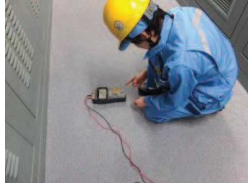
②電池容量確認
