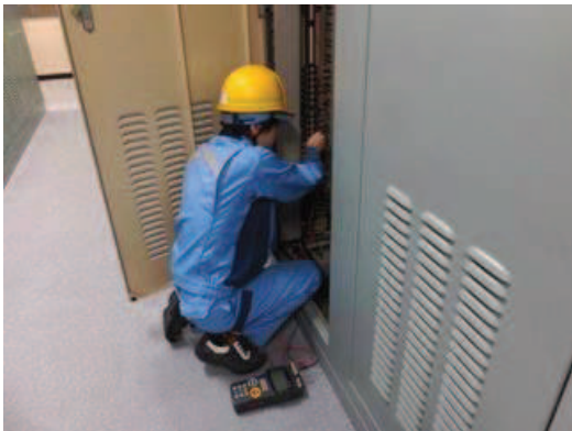
③可搬型計測器接続
