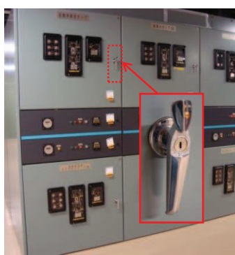
電源盤の施錠
