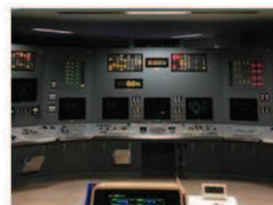
直流照明兼非常用照明点灯時のイメージ （写真：シミュレータ設備）
