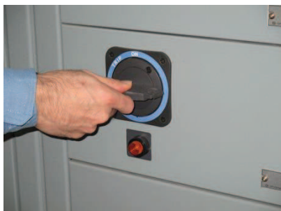
遮断器「切」操作
