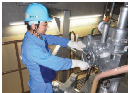
現場手動ハンドルによる閉操作
