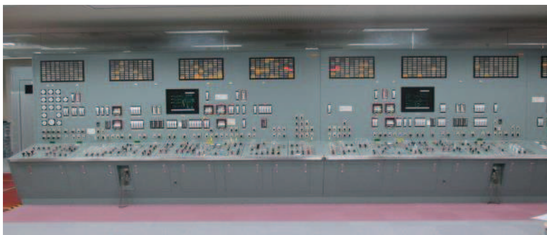
原子炉冷却制御盤
