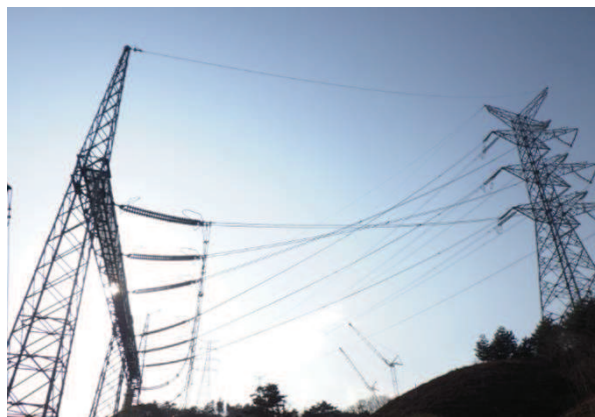
図 10.2.3-4 第 3 号機開閉所引留鉄構の架線状況
