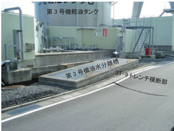
写真① 沈下発生状況
