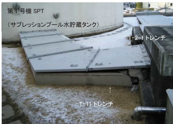
写真㊦ 沈下発生状況
