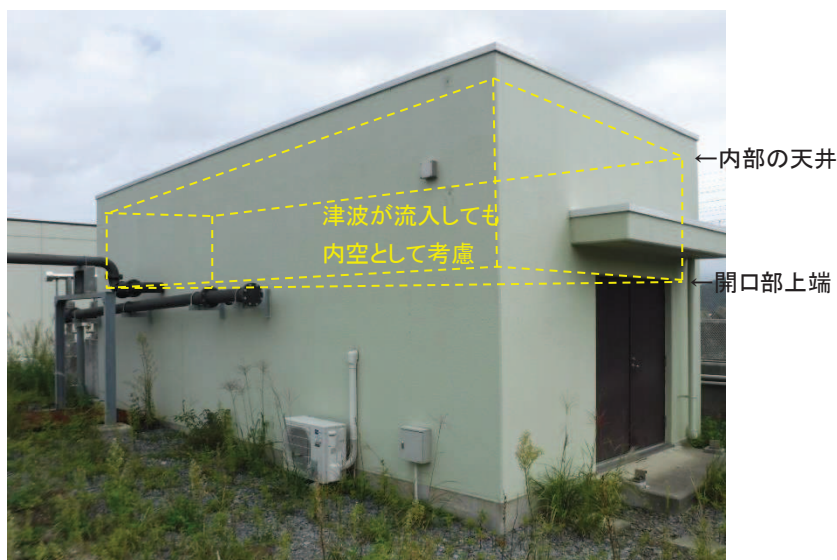
図 4.2-18 開口部が破損して建物内部に津波が流入しても内空として考慮する空間の例 (第 2 号機放流管真空ポンプ室 (No. 5) の例)
