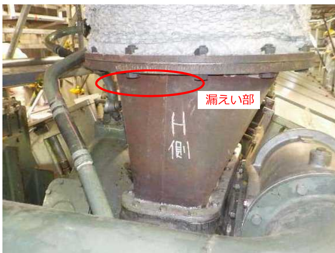
写真1. 当該の過給機出口配管フランジ溶接部
