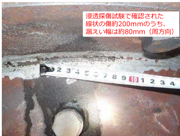
写真2. 当該の過給機出口配管フランジ溶接部 (漏えい部拡大)
