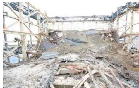
南側崩落屋根の状況
