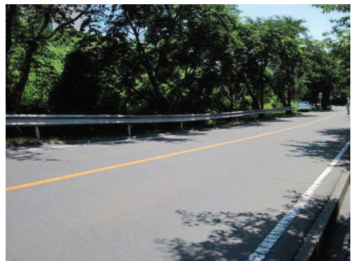
状況写真①
