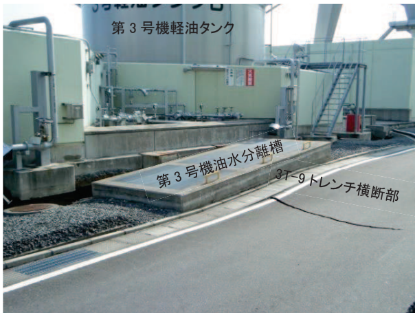
写真① 沈下発生状況
