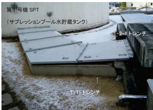
写真㊦ 沈下発生状況
