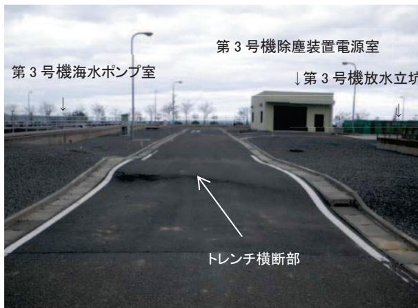
写真㉔ 沈下発生状況
