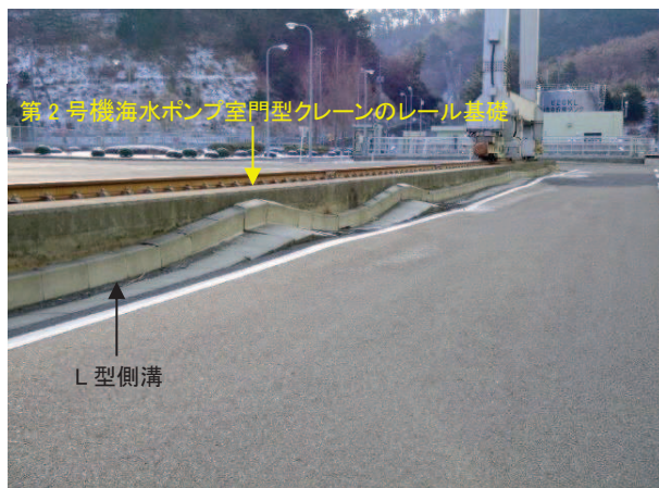
写真㉕ 沈下発生状況
