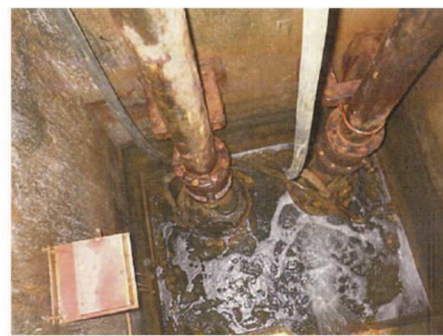
写真D 揚水井戸⑤(下段部) 2017/3/17撮影
