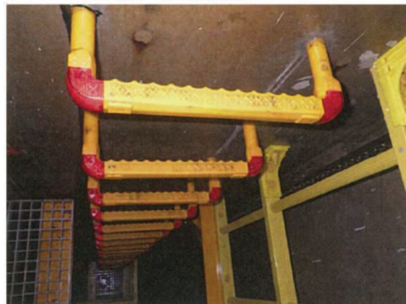
写真C 揚水井戸⑤(中段部) 2017/3/17撮影
