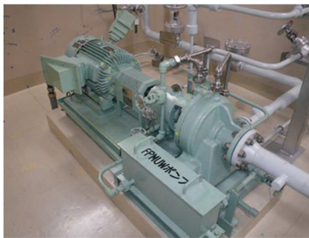
燃料プール補給水ポンプ
