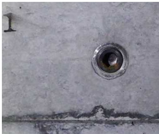
ベント孔 (開放前)
