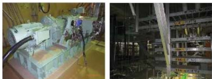
ポンプ、配管、支持構造物の例 ケーブルトレイ、電線管の例
