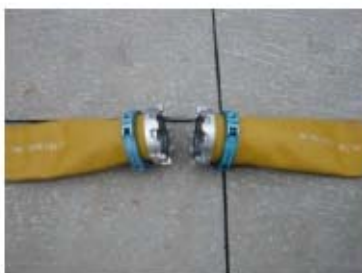
可搬型ホース (150A) 接続口
