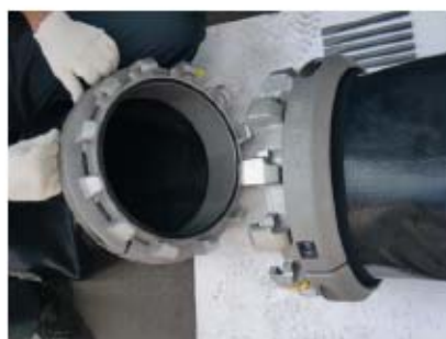
可搬型ホース(300A)接続口
