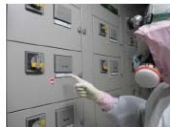
ディーゼル発電機燃料油移送ポンプ 起動操作 (ディーゼル発電機制御盤室) (原子炉建屋 T. P. 10. 3m)
