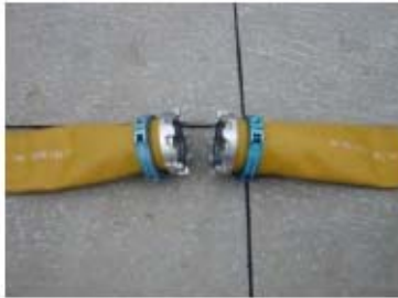
可搬型ホース (150A) 接続口
