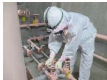
系統構成 (ディーゼル発電機燃料油サービスタンク室) (原子炉建屋 T. P. 17. 8m)
