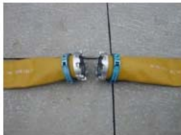
可搬型ホース(150A)接続口
