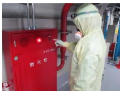
消火ポンプ起動 （原子炉建屋 T. P. 40. 3m）
