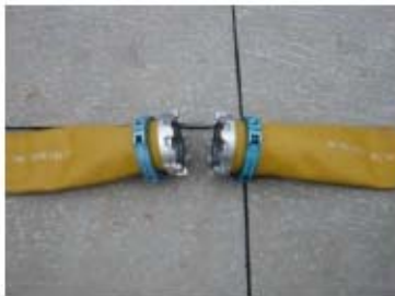
可搬型ホース(150A)接続口
