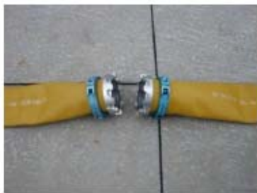
可搬型ホース(150A)接続口
