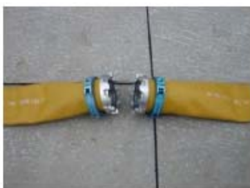
可搬型ホース(150A)接続口
