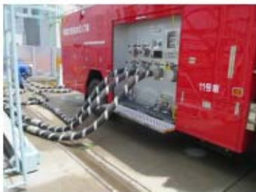
可搬型大型送水ポンプ車の設置 ポンプ車周辺のホース敷設 (屋外 T. P. 10m)
