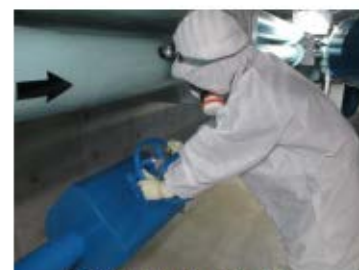
補機冷却水（海水） 通水開始前系統構成 （運転員（現場）②） （原子炉建屋 T. P. 2.8m）
