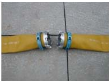
可搬型ホース (150A) 接続口
