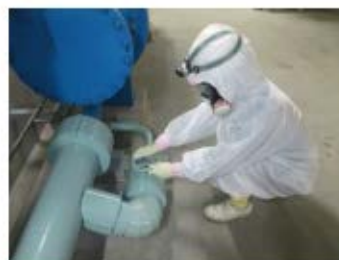
海水系統水抜き (原子炉建屋 T.P. 2. 8m)
