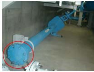
原子炉補機冷却水系統の 可搬型ホース接続口 (原子炉建屋 T. P. 2. 3m)
