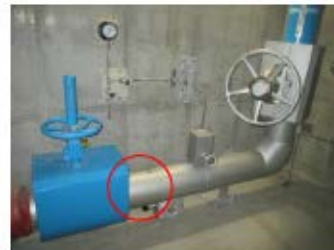
可搬型温度計測装置設置場所（排水側） （原子炉建屋 T.P. 17.8m）
