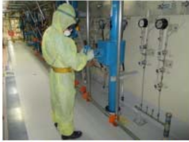
補機冷却水（海水）通水系統構成 （運転員（現場）①） （原子炉補助建屋 T. P. -1. 7m）
