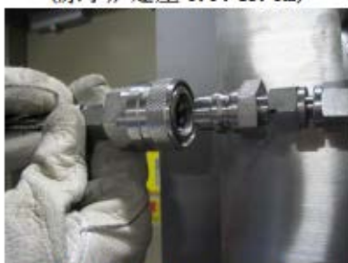
原子炉補機冷却水サージタンク 窒素供給ホースカップラ接続 (原子炉建屋 T. P. 43. 6m)
