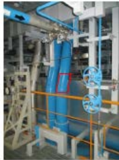
可搬型温度計測装置設置場所（供給側） （原子炉建屋 T.P. 14.3m）
