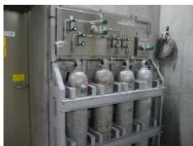
原子炉補機冷却水サージタンク 加圧用可搬型窒素ガスポンペ (原子炉建屋 T. P. 43. 6m)
