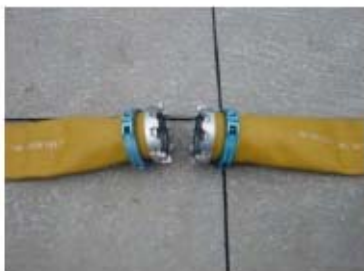
可搬型ホース (150A) 接続口
