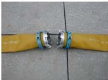
可搬型ホース (150A) 接続口
