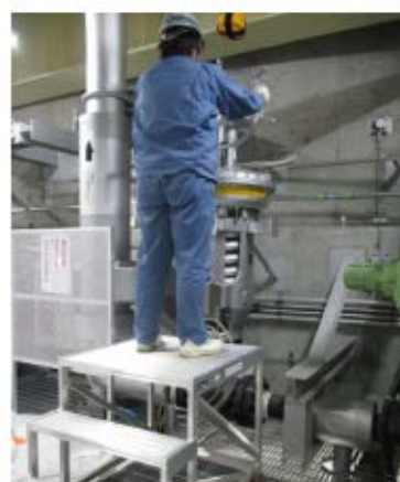
常用照明消灯時 (バッテリー内蔵型照明点灯)
