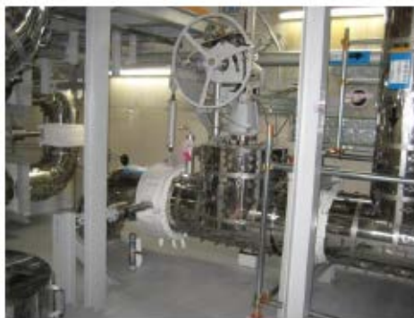
余熱除去ポンプ入口弁 (原子炉補助建屋 T.P. 2.8m)
