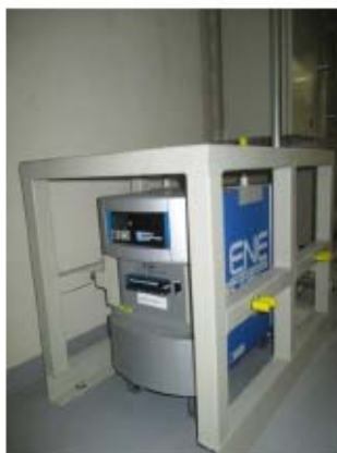
加圧器逃がし弁操作用バッテリー （原子炉補助建屋 T.P. 10.3m）
