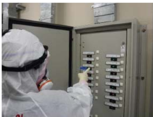
加圧器補助スプレイ弁電源入 （原子炉補助建屋 T.P. 10.3m）
