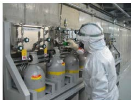
主蒸気逃がし弁 代替制御用空気供給操作 (原子炉建屋 T. P. 10. 3m)
