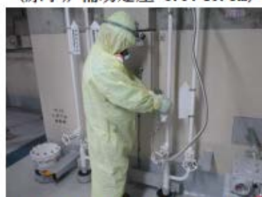
窒素供給操作(系統側バルブ操作) (原子炉補助建屋 T.P. 40.3m)
