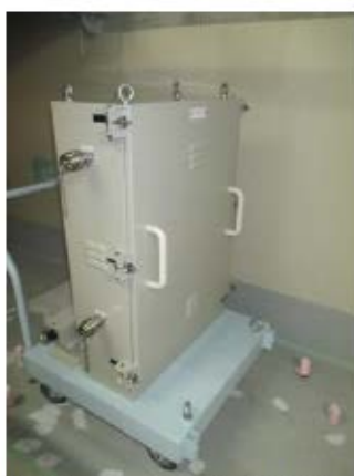
可搬型アンユラス水素濃度計測ユニット (原子炉建屋 T.P. 24. 8m)
